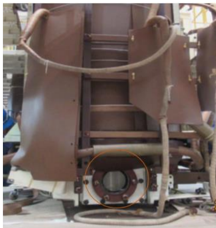
Figura 2.6 - Entrada de tubulação para conexão com o núcleo.
