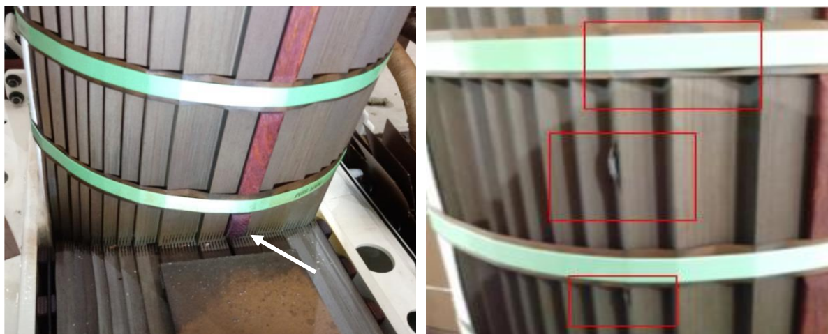
Figura A.8 Detalhe Núcleo: (a) pontos de aquecimentos no julgo inferior; (b) pontos de deformação por possível impacto
