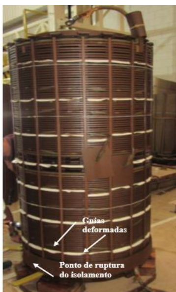
Figura A.6 –Enrolamento AT com indicações do ponto de ruptura na base da bobina e demais guias deformadas.
