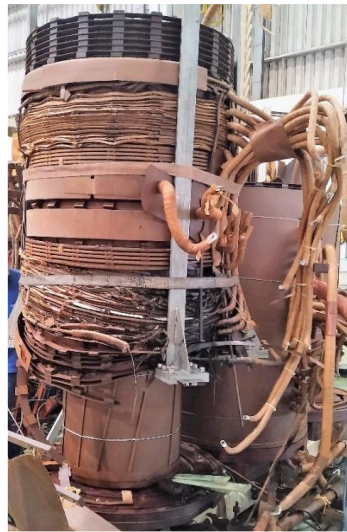
Figura 7.20 - Bobina RAT em falha com deformação e curto-circuito entre espiras.
